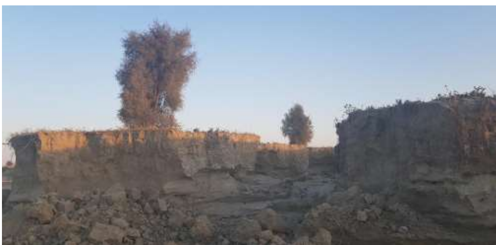
تخریب بسیار شدید و وسیع
