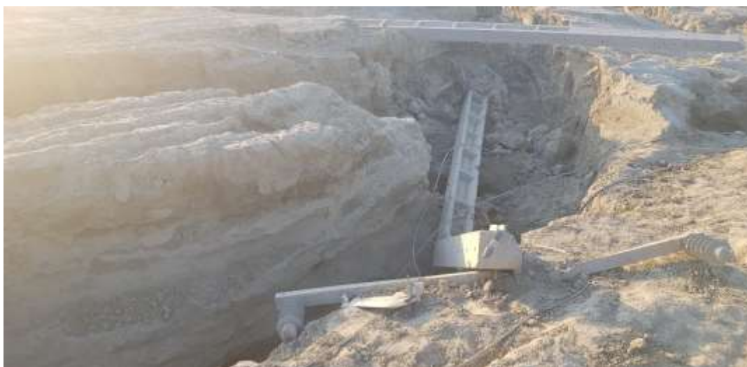
فرسایش خندقی و تخریب تیرهای برق پایین دست و حوالی رودخانه کاجو
