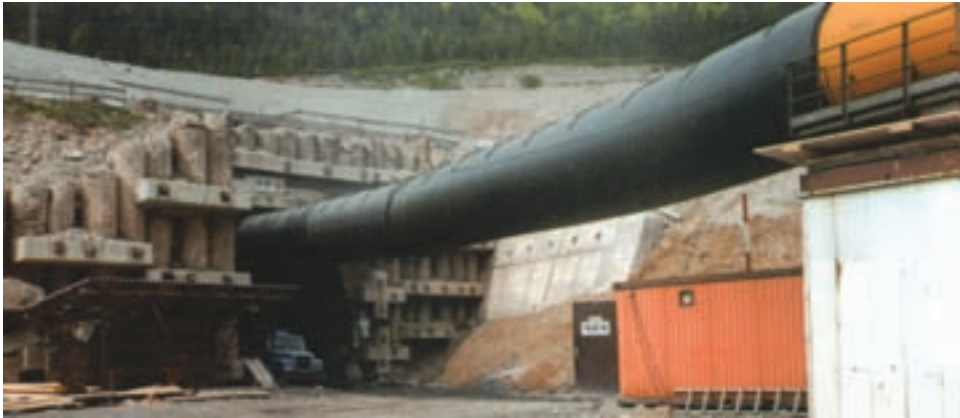
شکل ۳۶-۲- لوله‌های فلزی تهویه با اتصالات جوشکاری شده
